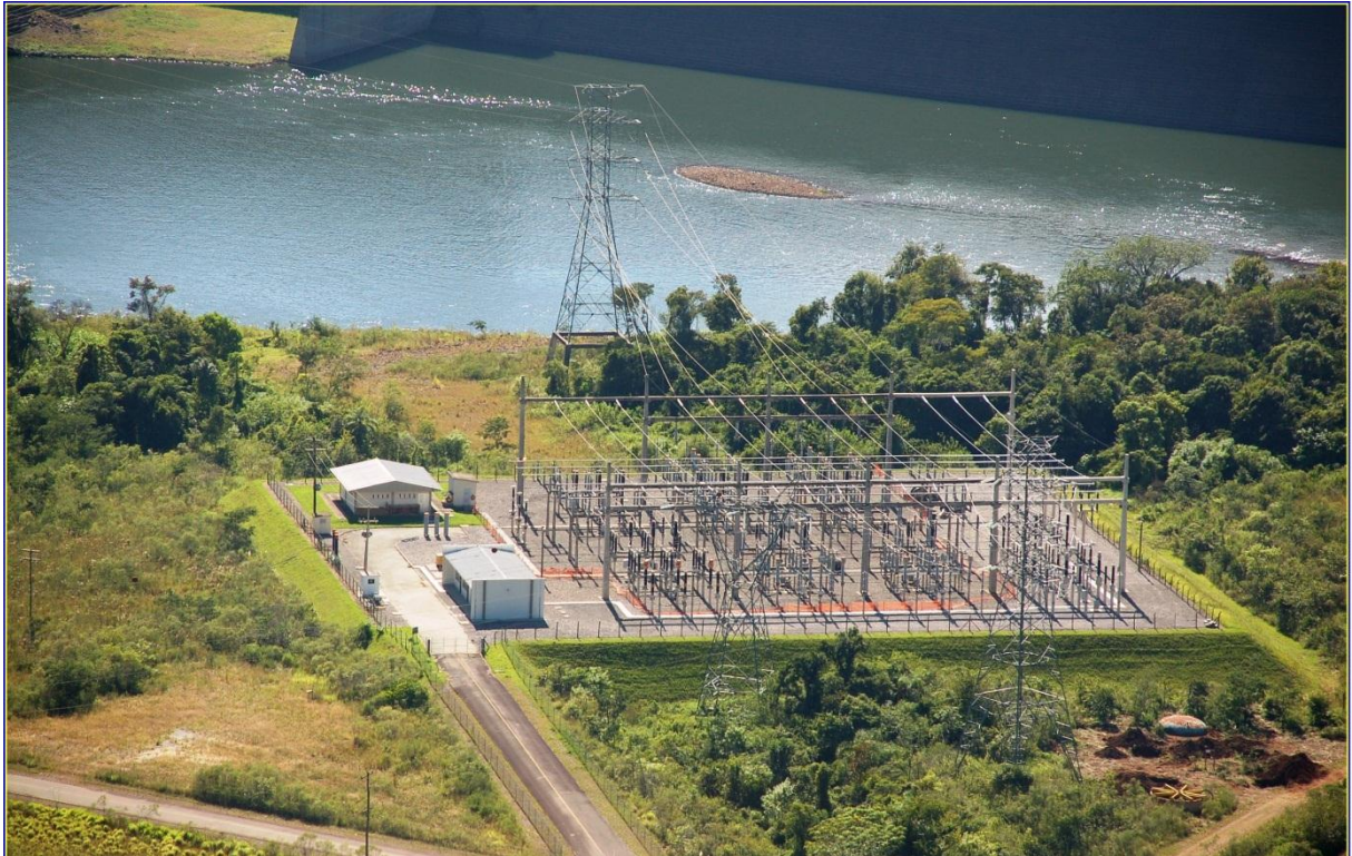
Figura 3- Subestação localizada no território do Município de Agudo
