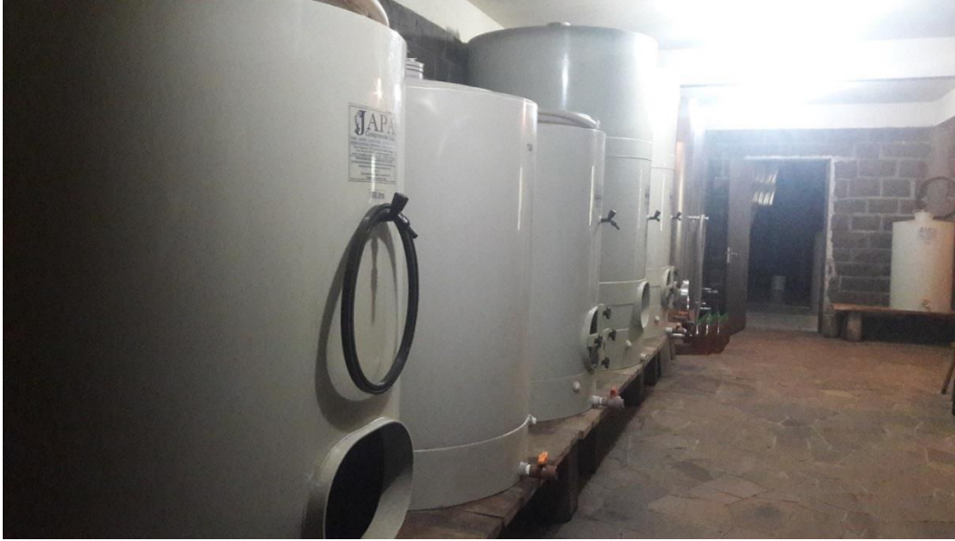
Foto 4 - Pipas de inox (atualmente)
